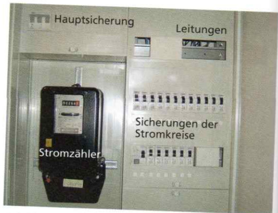
2 Zählverteilerschrank mit automatischen Sicherungen
